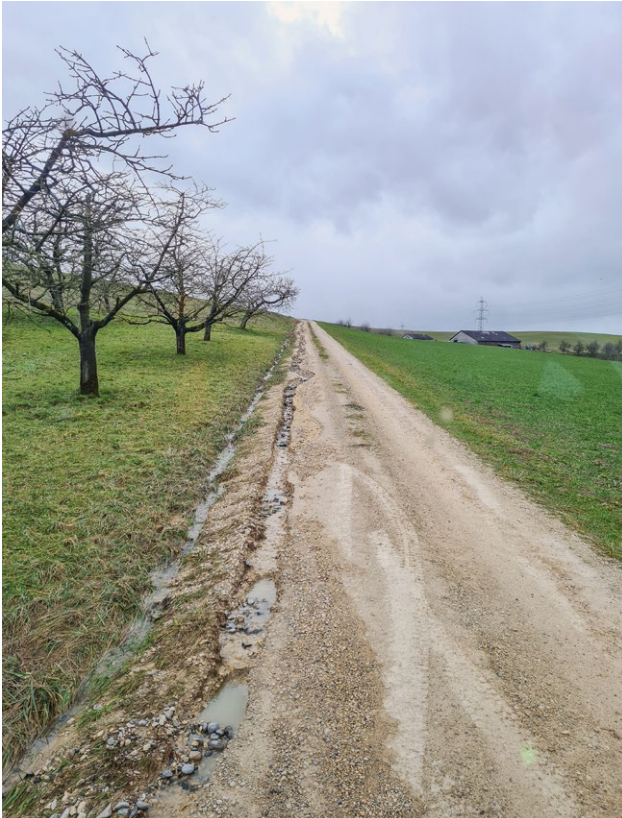
Schäden an Flurwegen.
